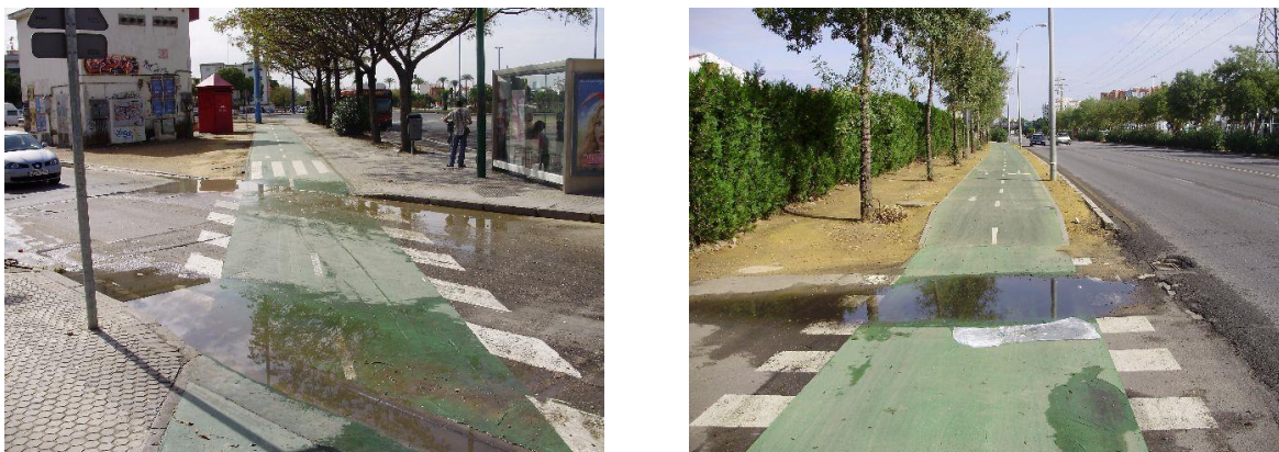
Problemas de permeabilidad en el pavimento. Fuente: Blog Carriles bici Sevilla
