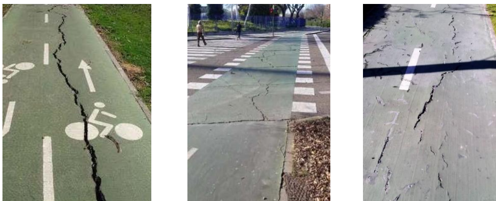
Deterioro de los carriles bici. Fuente: Patinadores de Sevilla
