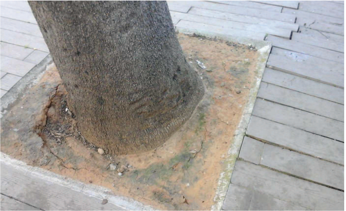
Detalle del fallo de la plataforma radicular. Levantamiento de la zona de tensión y hundimiento de la zona de compresión
