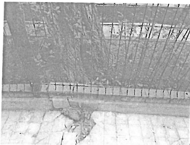
Detalle del deteriorado acerado por efecto de la inclinación del copioso Árbol)
