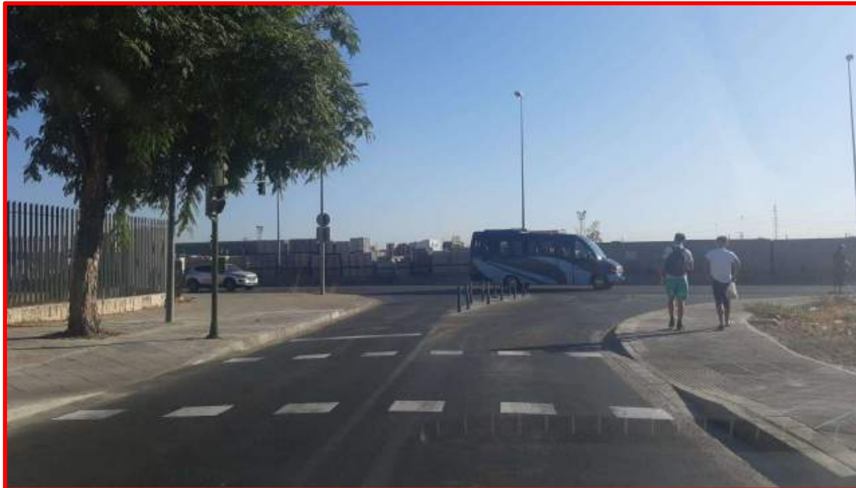
Construcción de rebaje en paso de peatones Ronda de La Doctora Oeste
