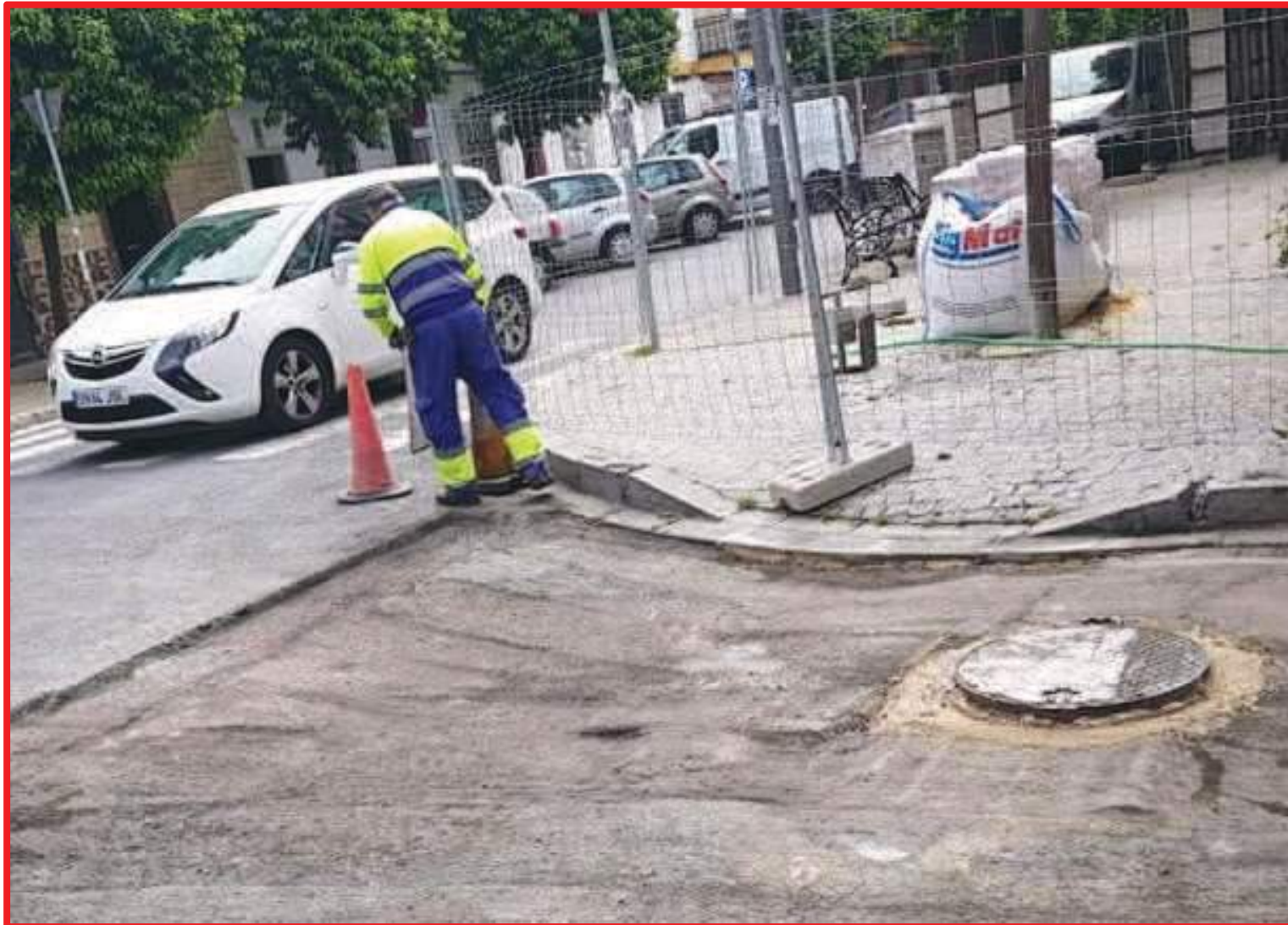
Arreglo levantamiento tapas de Emasesa en calzada C/ Párroco Antonio Gómez Villalobos
